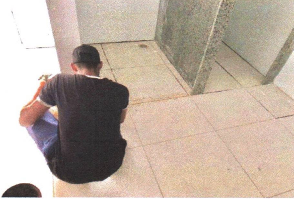
REJUNTE INTERNO DOS VESTIÁRIOS DAS QUADRAS DE AREIA
